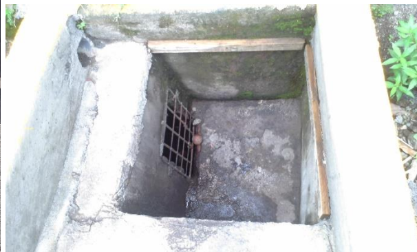
CR 9 además funciona como tragante
