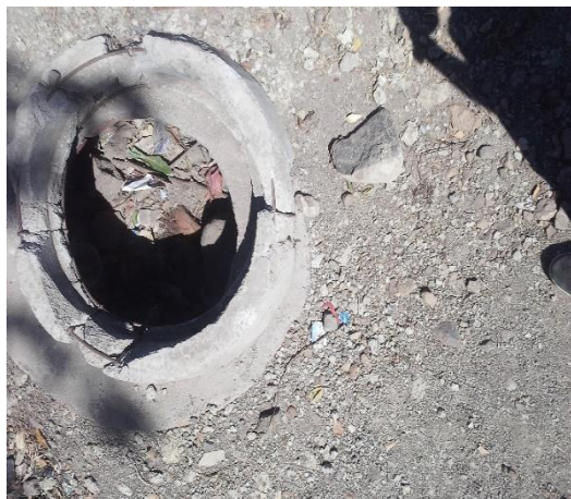
PVS 316 en mal estado
